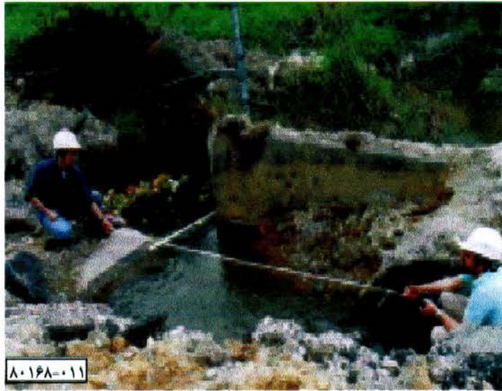
شکل ۱-۱۱: شکستگی خط لوله و تخلیه فاضلاب در محیط در هنگام وقوع زلزله*.
