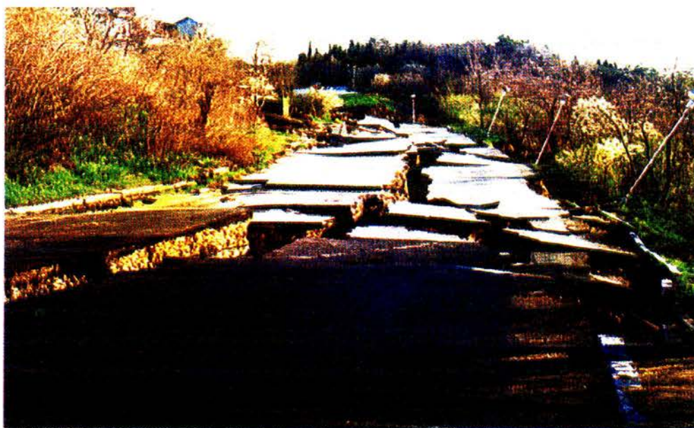
شکل ۱-۳: ترکها و شکافهای عمیق در اثر زلزله که می توانند تخریب جدی در ۸۰۱۶۸-۰۰۳ تاسیسات زیرزمینی نظیر لوله های آبرسانی را باعث شوند*.
