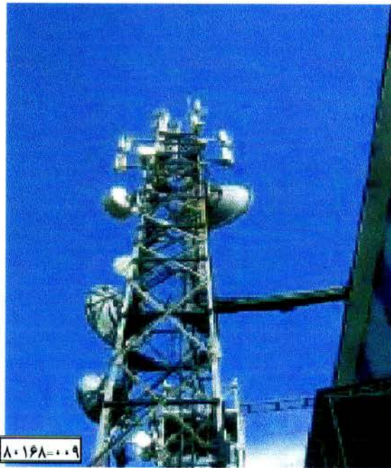
شکل ۹-۱: برج رله از تاسیسات مهم سیستمهای ارتباط از راه دور که ممکن است در زلزله های شدید دچار مشکل شود.&
